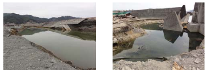
東北地方太平洋沖地震津波による洗掘例
