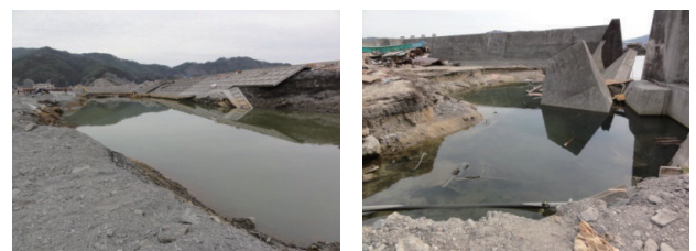
東北地方太平洋沖地震津波による洗掘例
