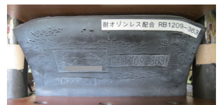
ゴム支承表面のクラックを再現
